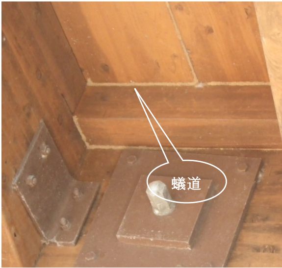
写真 2.2.5 しろありの蟻道の事例
