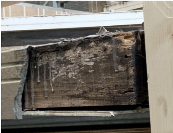
写真 2.1.1 木造階段の外装材料の 欠損と木材の腐朽の事例
