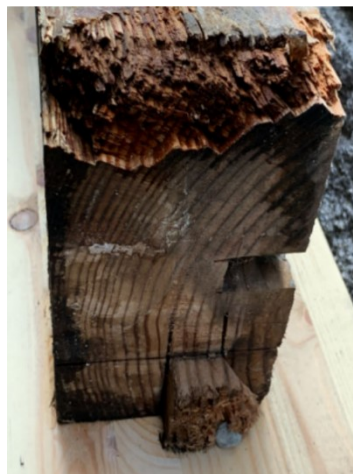
写真 1.2.3 水分の浸入により木材が腐朽した様子
