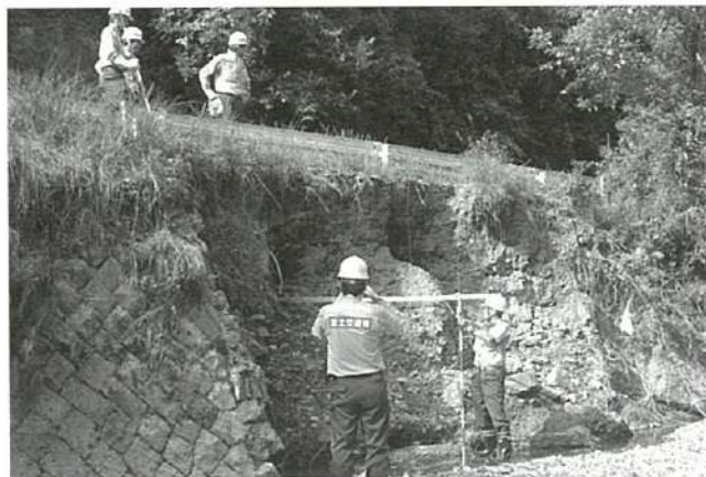
木住川における近畿テック・フォースの被災状況調査
