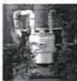
(ガスメーター)
