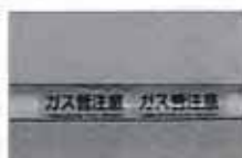
(架空配管部への標示)
